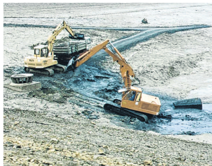
Entschlammung des Hauptsees: Mit Baggern wurde der Schlamm auf Lastwagen geladen und abtransportiert. FOTO: WASSERWIRTSCHAFTSAMT
