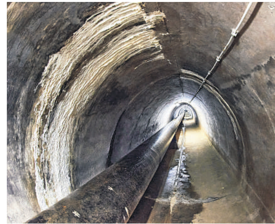
Die Rohrauslassleitung im Ellertshäuser See wird von Mikroben zerrissen. Sie soll ausgetauscht werden.
